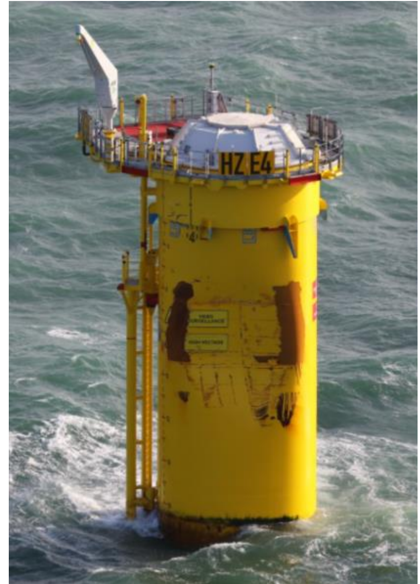
Hollandse Kust Zuid TP damage, source: Vattenfall
